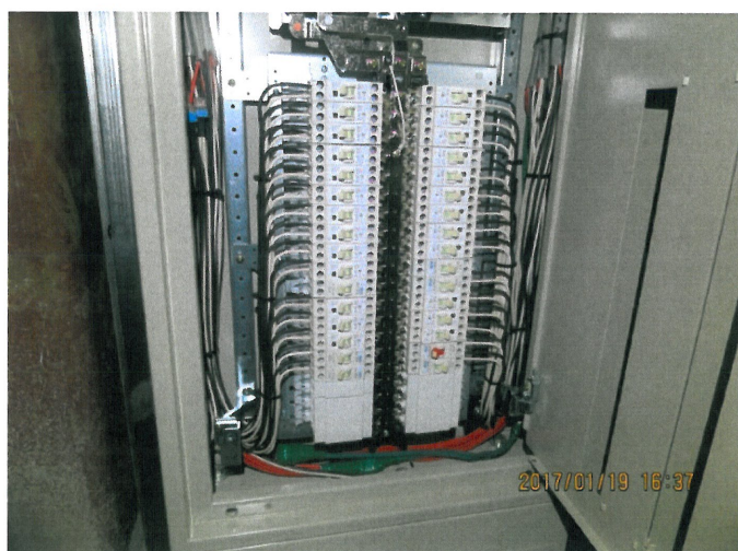
電灯分電盤内部
